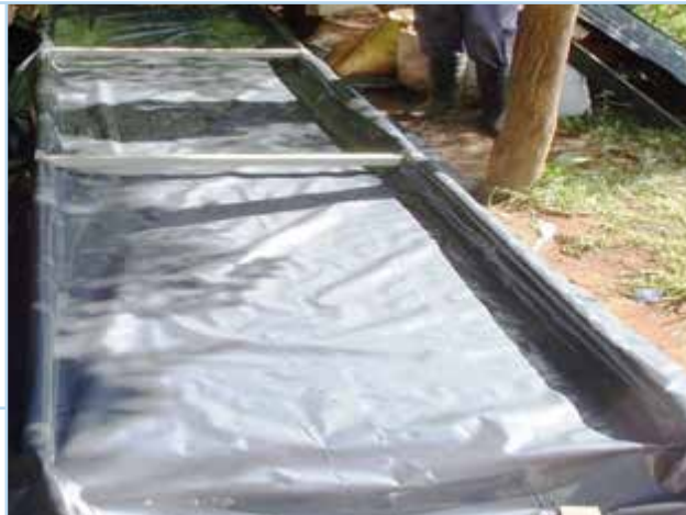
FIGURA 52 LÁMINA PLÁSTICA DE REVESTIMIENTO INTERNO DEL COLECTOR.
